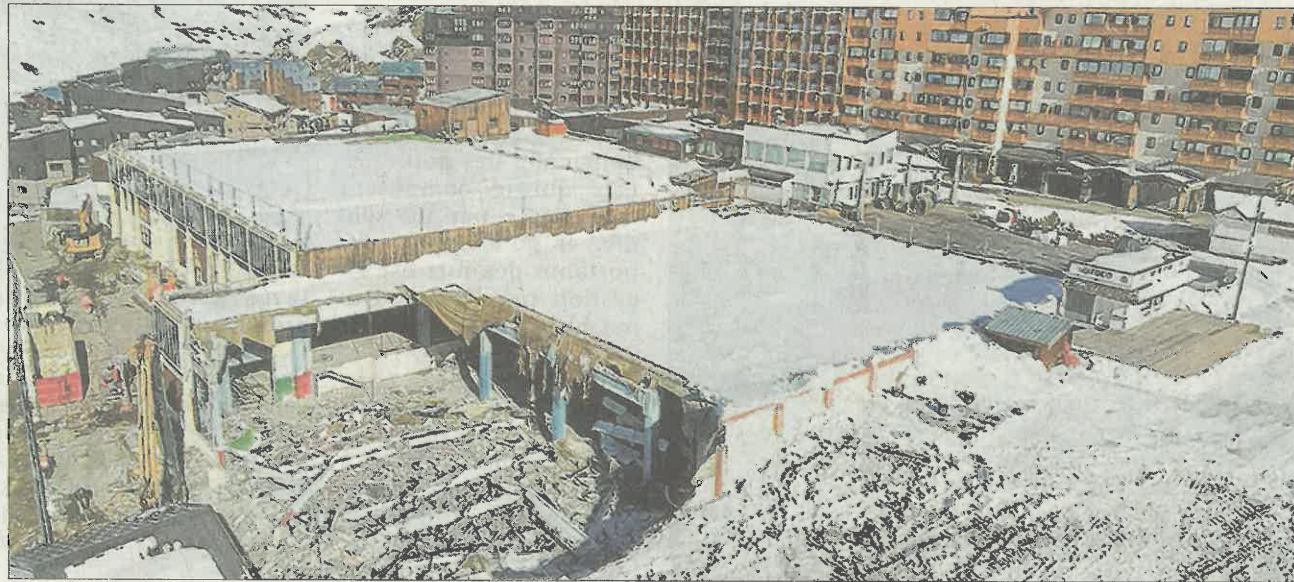
L'impressionnant chantier de démolition a été lancé au début du mois. Photo Le DL/G.S.
